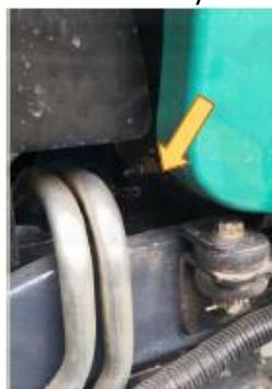
Zawór spustowy zbiornika wody
